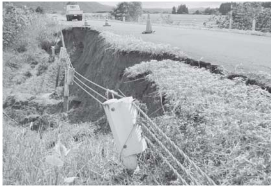
路肩が崩落した町道 (誉地区)
