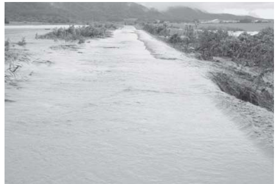
冠水した町道 (誉地区)
