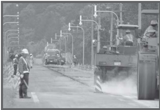
工事名：凍雪害防止事業嘗旧国道線舗装新設工事★ 完了：10月30日(金) 内容：道路の舗装工事
