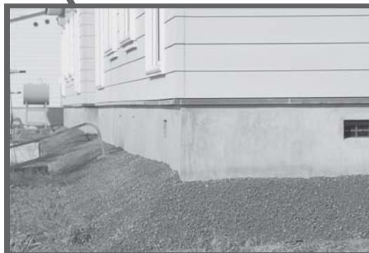
工事名：中央団地公営住宅軒下盛土工事◇ 完了：10月30日(金) 内容：軒下の盛土
