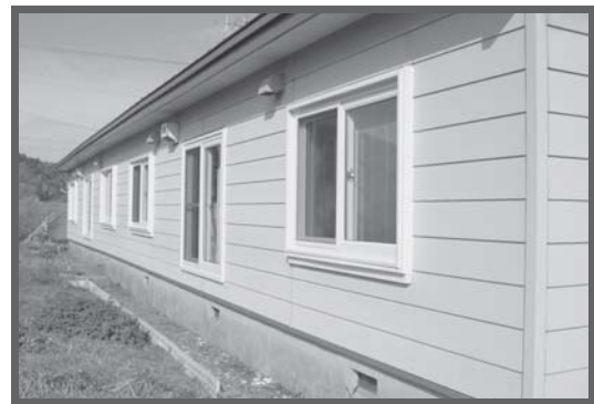
工事名：佐久第2団地サッシ改修工事◇ 完了：10月30日(金) 内容：木製サッシを樹脂サッシへ交換
